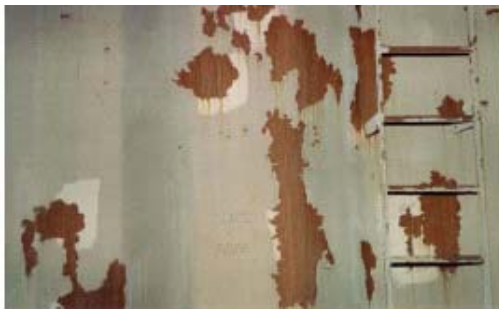
Fig. N° 3.- Desprendimiento de pintura [1]
