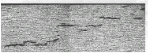
Fig. N° 2.- Agrietamiento de capas de pintura [3]
